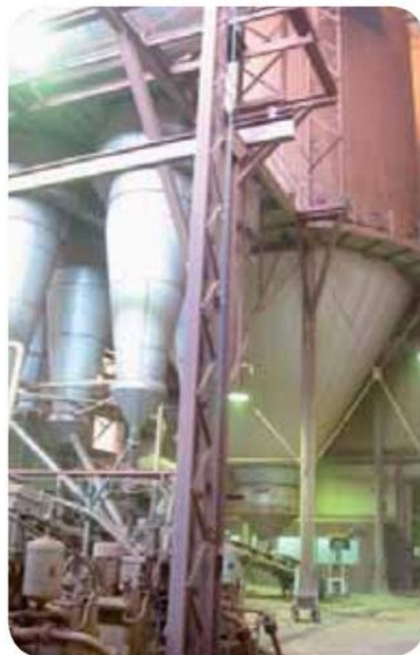
FOTOGRAFÍA 1.7. Vista general de un secadero por atomización.
